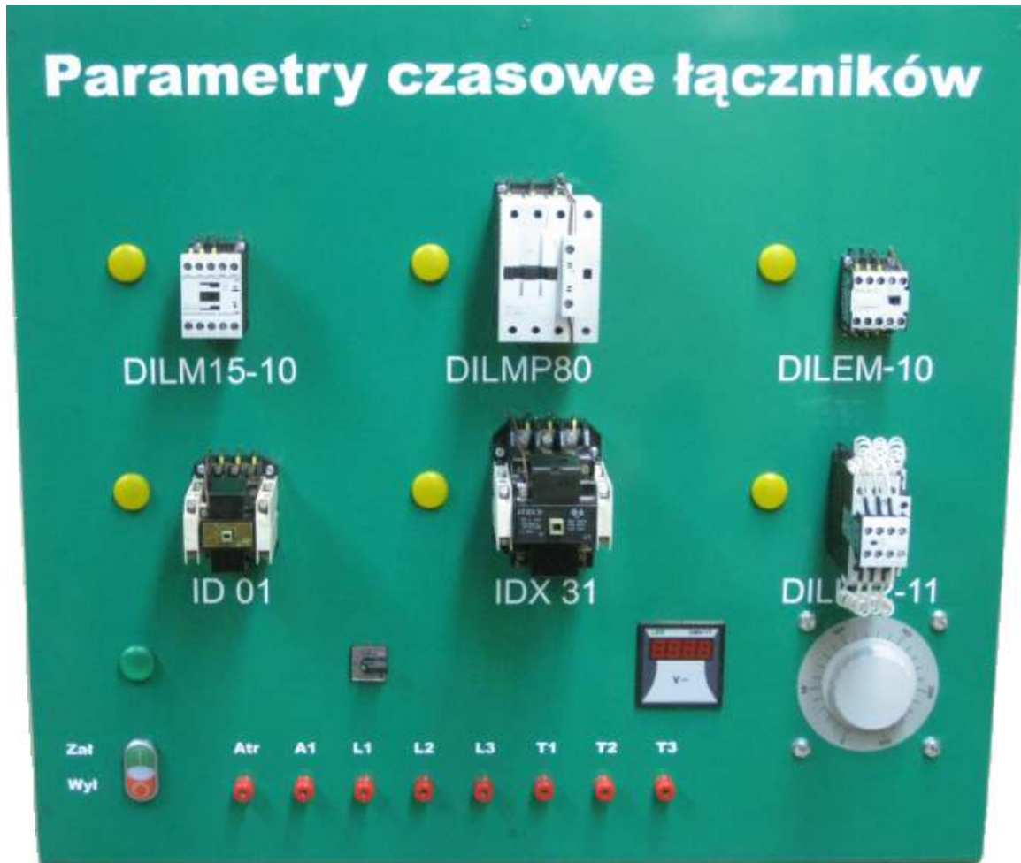
Rys. 7.1. Płyta czołowa panela sterowniczego
